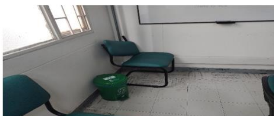
DETERIORO EN SILLAS
