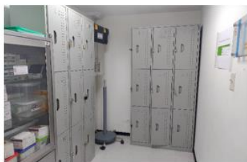
LOCKER SIN ANCLAR
