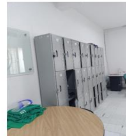
LOCKER SIN ANCLAR
