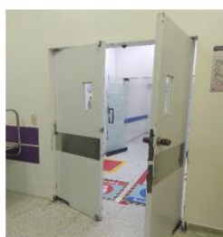
PUERTA DAÑADA E INSEGURA
