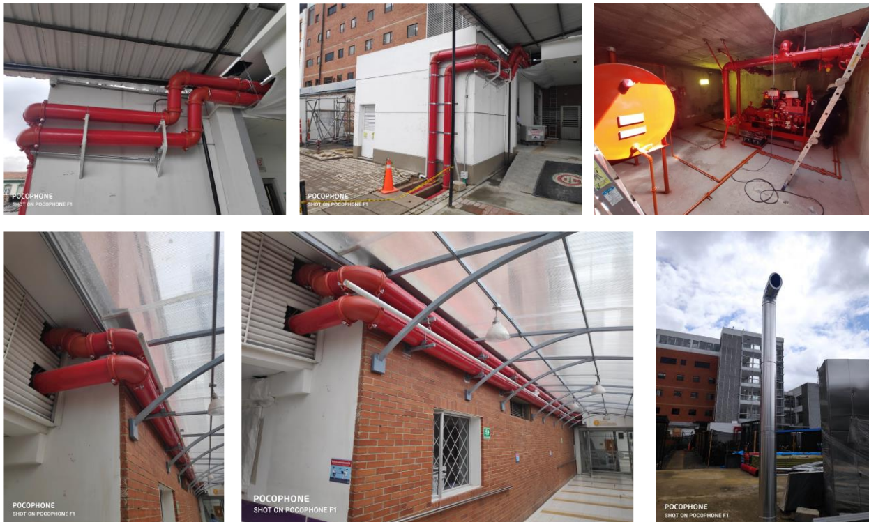
Ilustración 48. Sistema de bombas red de extinción de incendios
